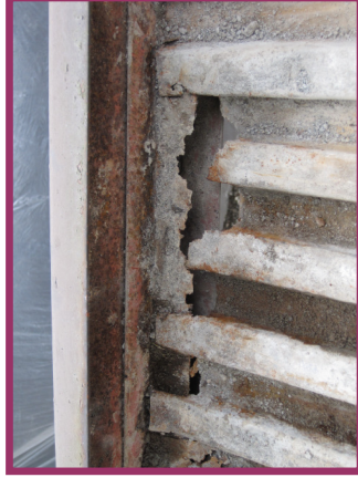
前桁側 キーストンプレートの腐食
