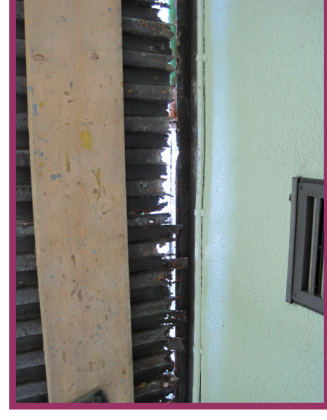
前桁側 キーストンプレートの腐食
