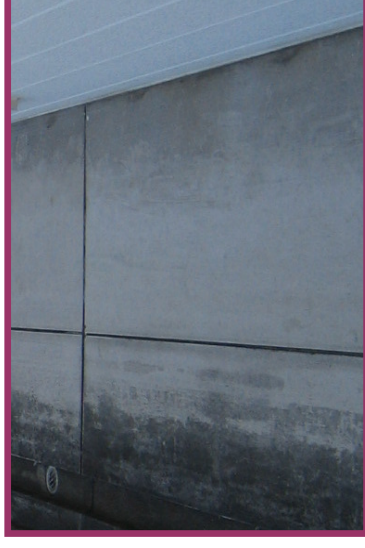
セメント成形板の汚れ 目地コーキングの劣化
