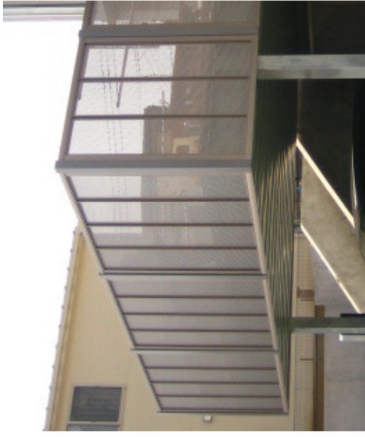
大型バルコニー 手摺：パンチング
