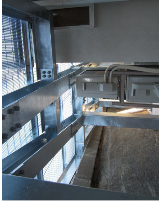
重量鉄骨架台
